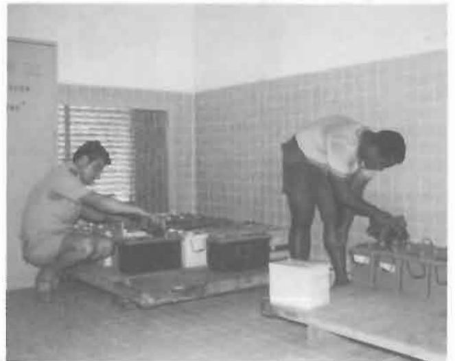
Le local batteries
