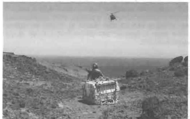
Démontage d'une station Trident avec panneaux Genewatt par hélicoptère Puma à Yandé (mars 1988)
